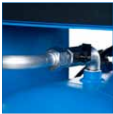
Bypass para desconexión del secador
